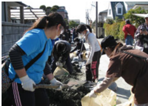
個人宅から依頼のあった側溝に溜まった土砂を撤去するボランティア活動
