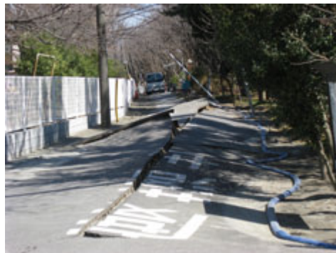
液状化による地割れ 写真左側(フェンスの奥)は小学校。
